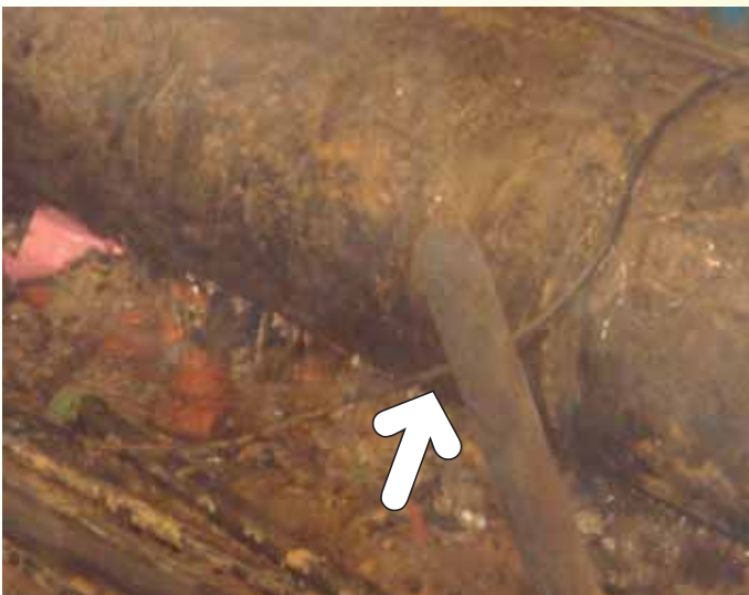
Längsriss im Gussrohr DN 350
